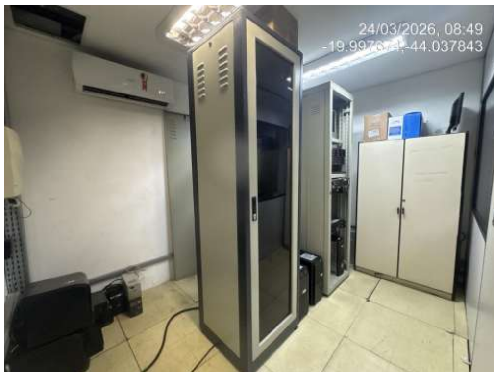
Foto 11: Sala de servidores
