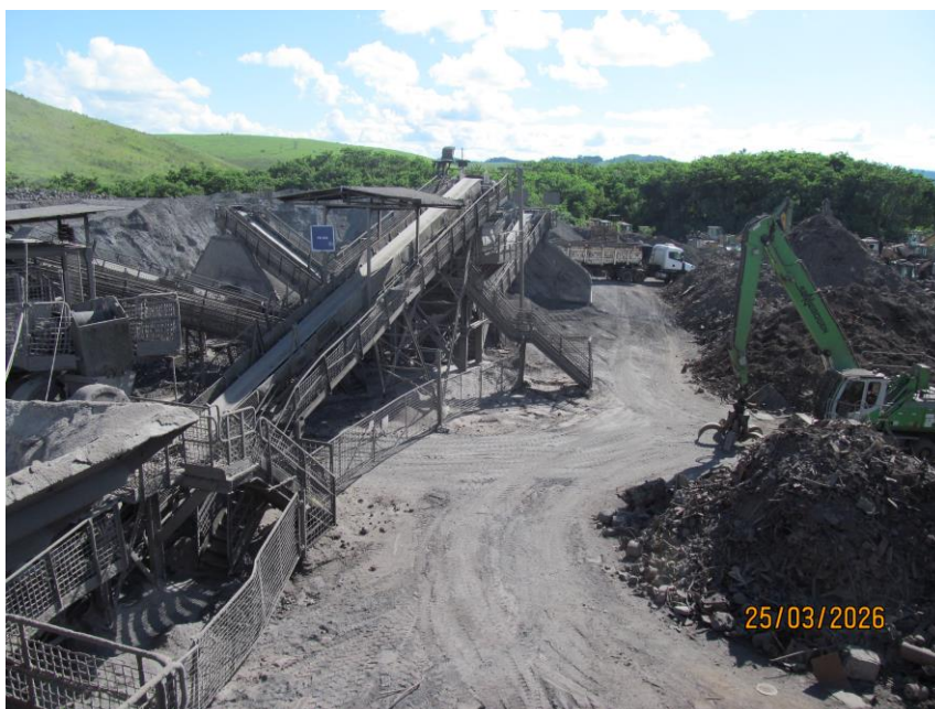
Vista GERAL 4 da PLANTA DE BENEFICIAMENTO DE METÁLICOS – PR-002 (Correias e diversos)
