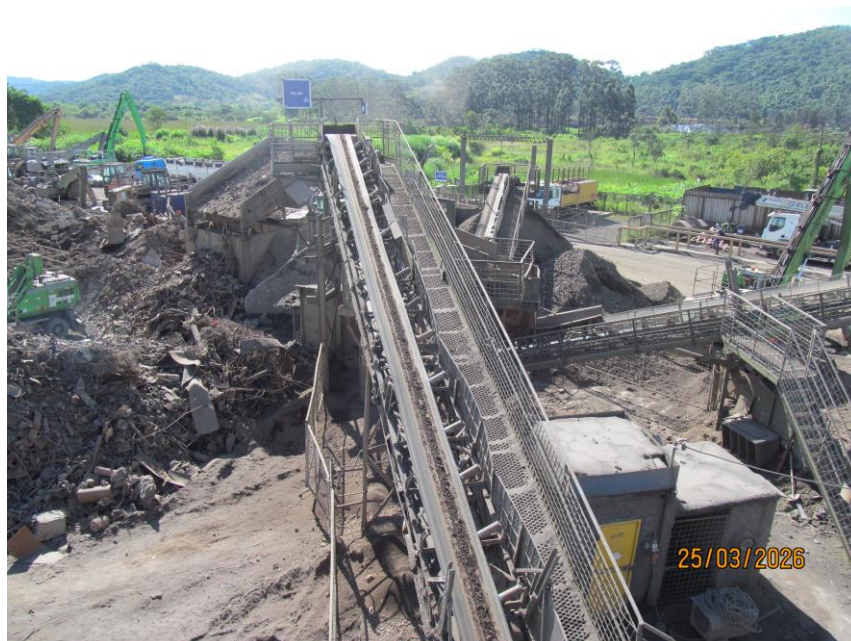
Vista GERAL 2 da PLANTA DE BENEFICIAMENTO DE METÁLICOS – PR-001
