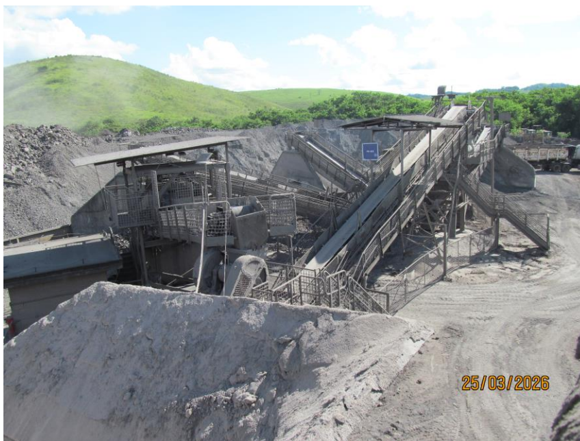
Vista GERAL 1 da PLANTA DE BENEFICIAMENTO DE METÁLICOS – PR-002 (Correias e diversos)
