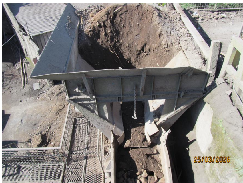
Vista GERAL 4 da PLANTA DE BENEFICIAMENTO DE METÁLICOS – PR-001 (Alimentador Vibratório)
